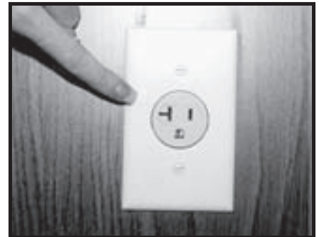
NEMA 5-20 20 amp Receptacle
